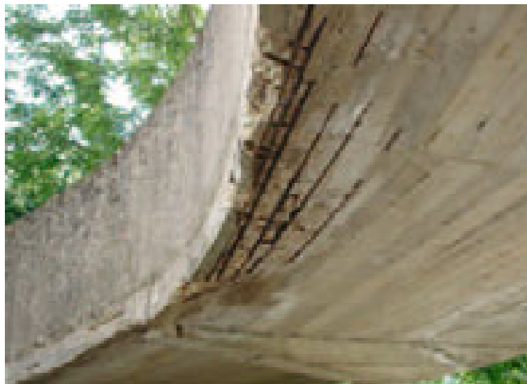
Betonabplatzungen infolge von Korrosion an der Unterseite einer Brücke.
